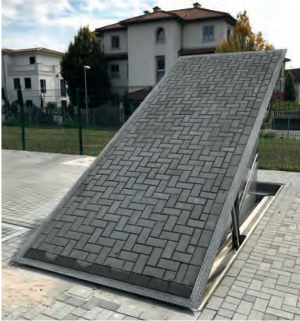
Einstieg in Pumpwerk, Seligenstadt
